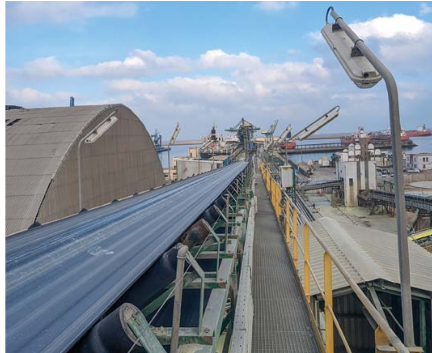
SISTEMA DE MANEJO DE CARBÓN. CENTRAL TÉRMICA JORF LASFAR - O.N.E.E (MARRUECOS)
