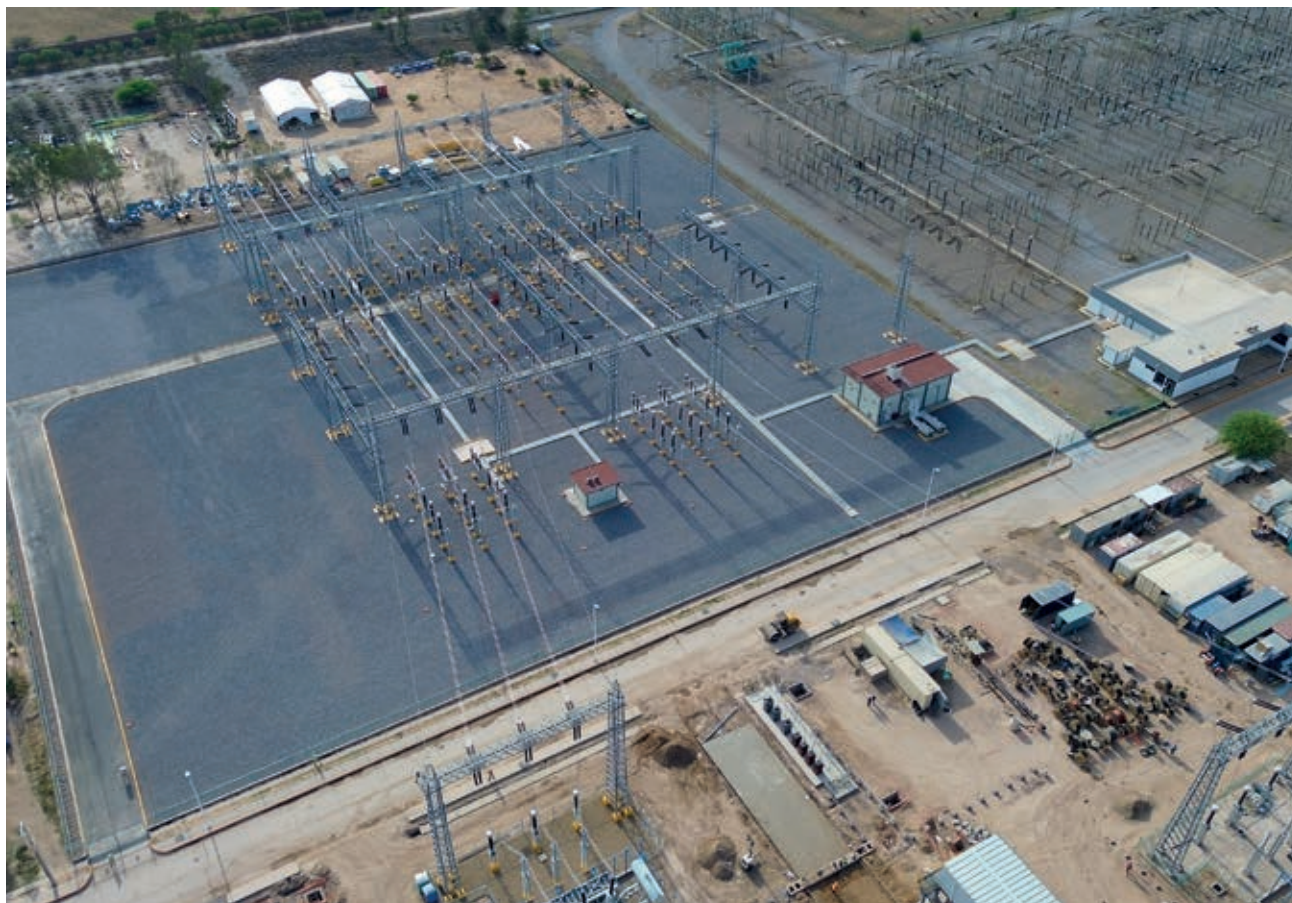
SUBESTACION 230KV. CENTRAL CICLO COMBINADO SAN LUIS DE POTOSÍ 450 MW (MÉXICO)
