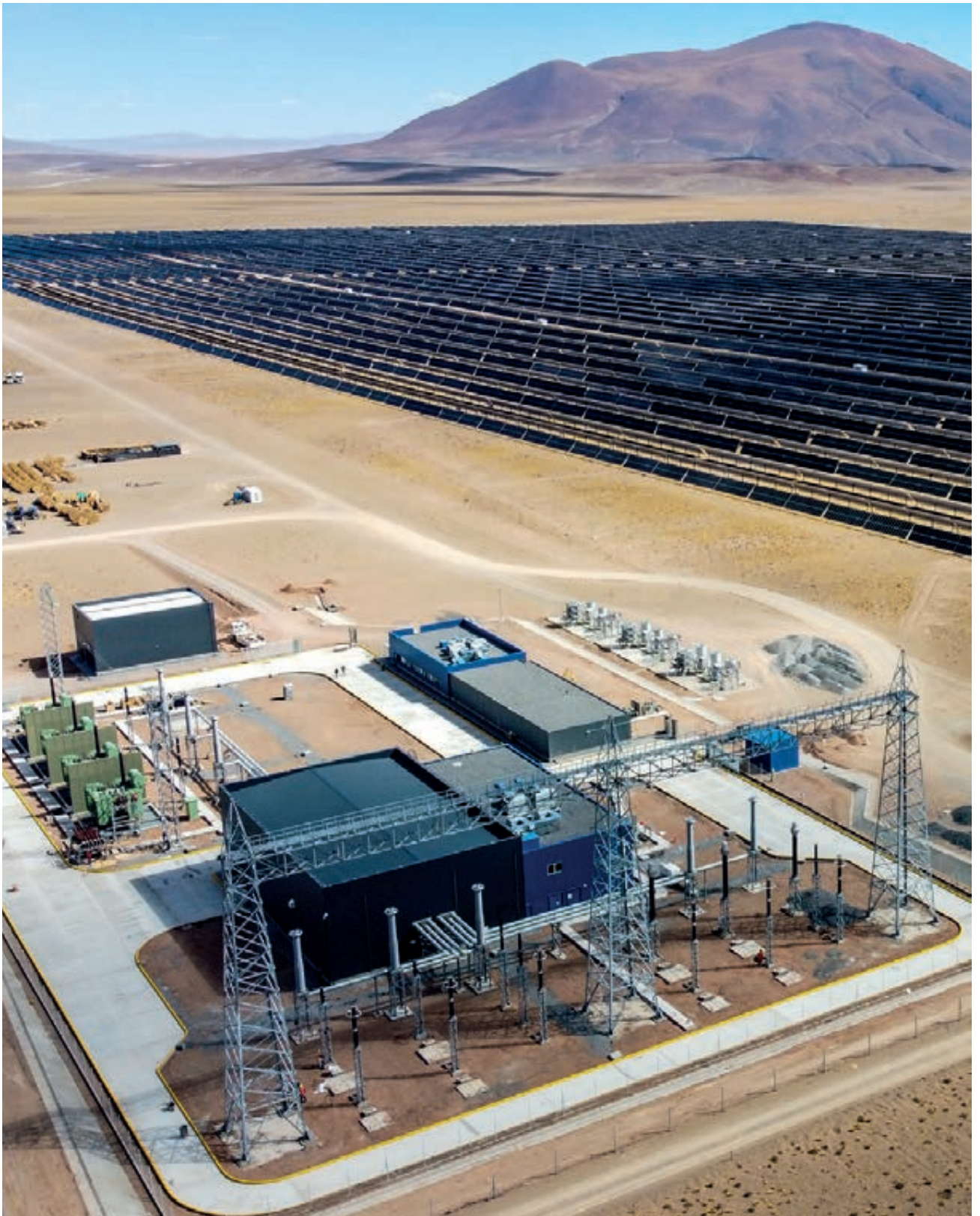
Complejo solar LA PUNA 208 MW. Plantas fotovoltaicas La Puna y Altiplano, Subestación 330 kV y Línea de Transmisión Argentina)
