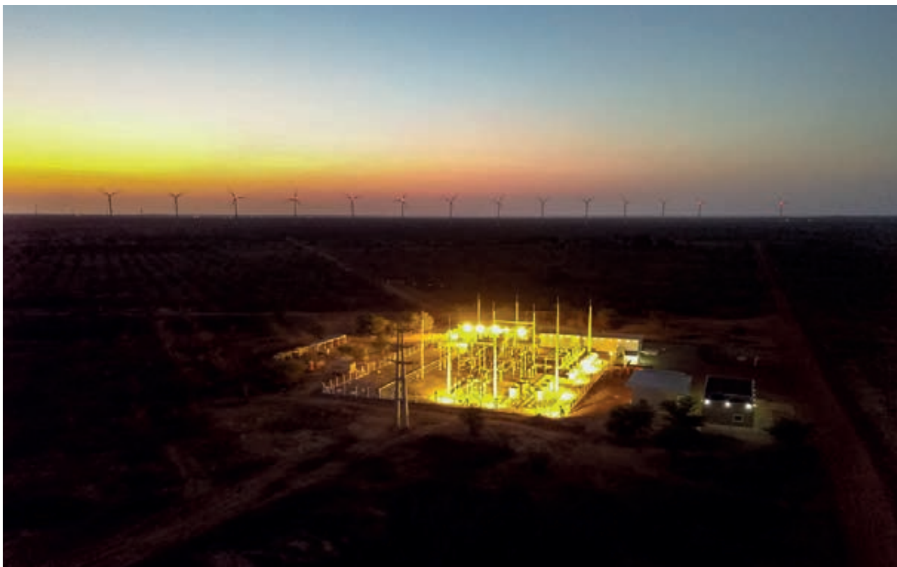
Complejo eólico JAU Y AVENTURA | 126,9 MW y Subestación Baixa do Feijao 138 kV. Río Grande Do Norte (Brasil)
