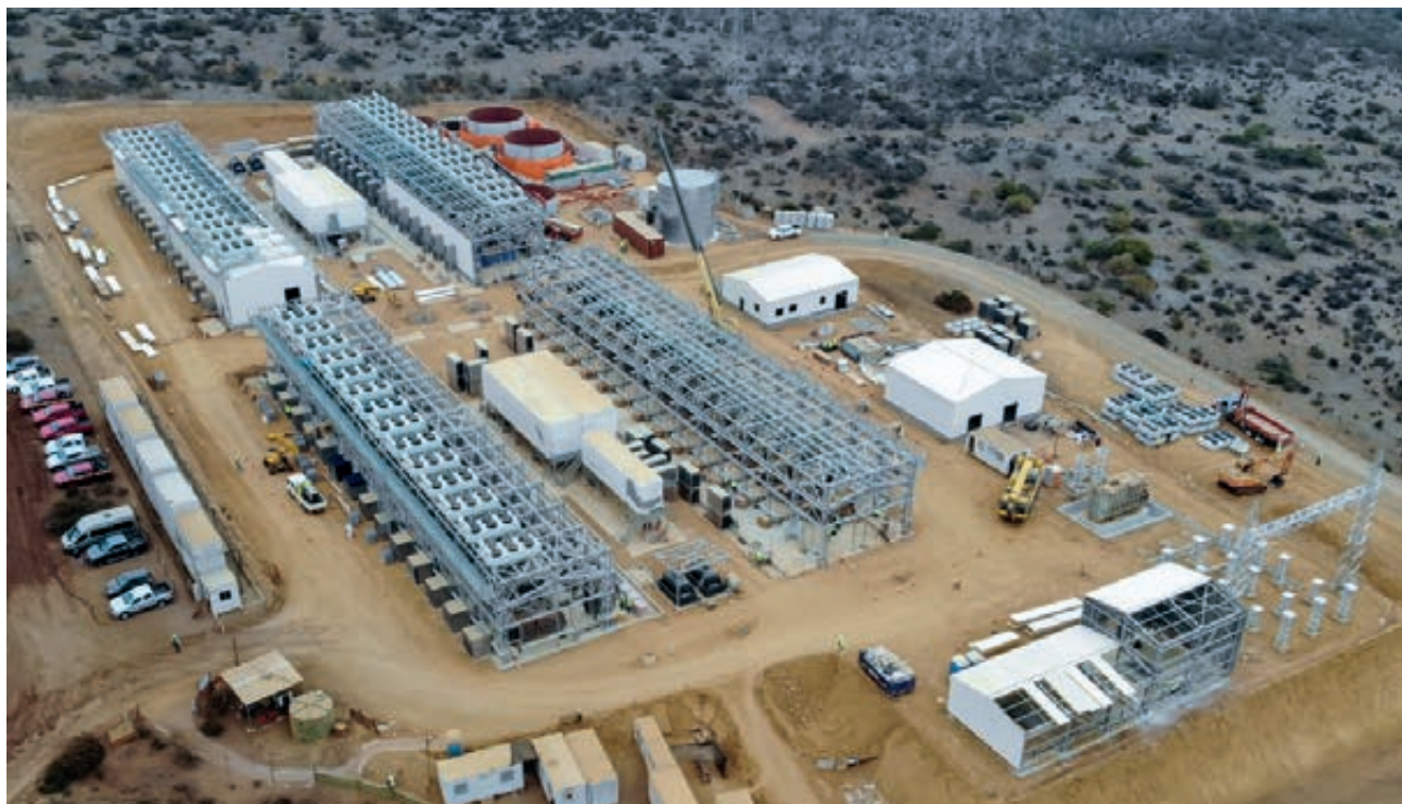
Central multisite de motores de gas QUICKSTART 475 MW (Chile)
