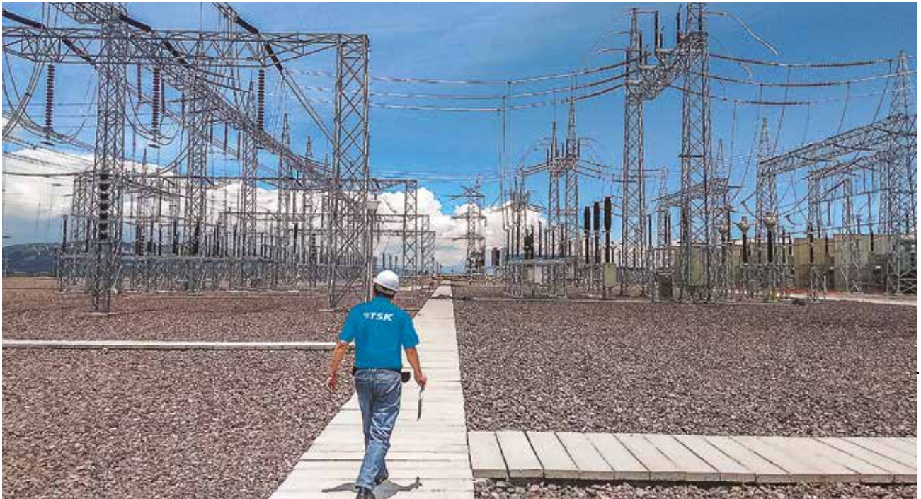
El Inga Substation, Riobamba (Ecuador)
