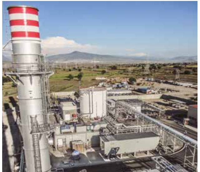
135 MW GT Power Plant. Valle de Mexico (Mexico)
