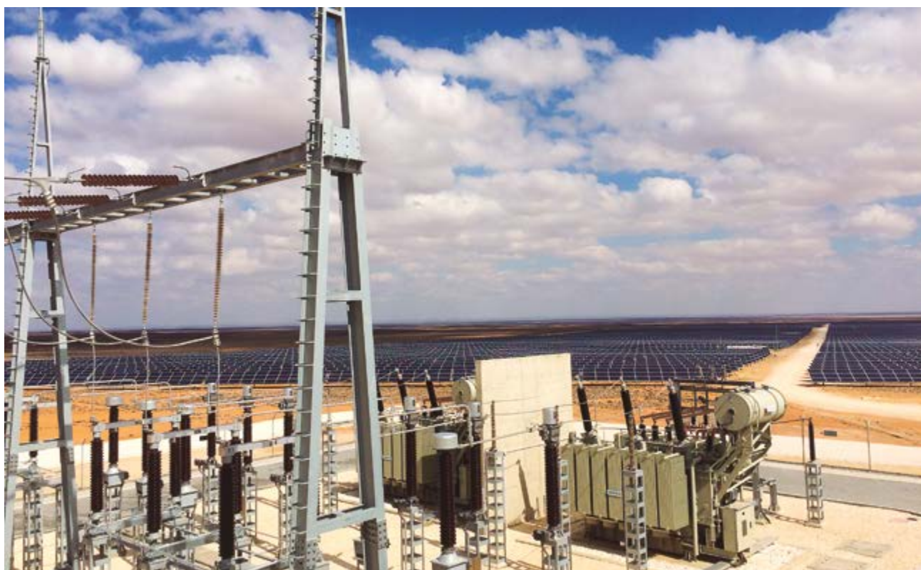
Planta fotovoltaica Al Safawi 67 MW. (Jordania)
