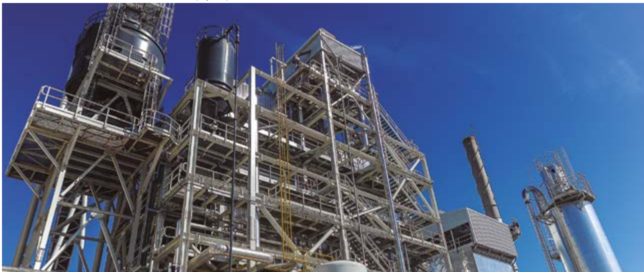
Planta de Biomasa de Reocín 10 MW. Cantabria (España)
