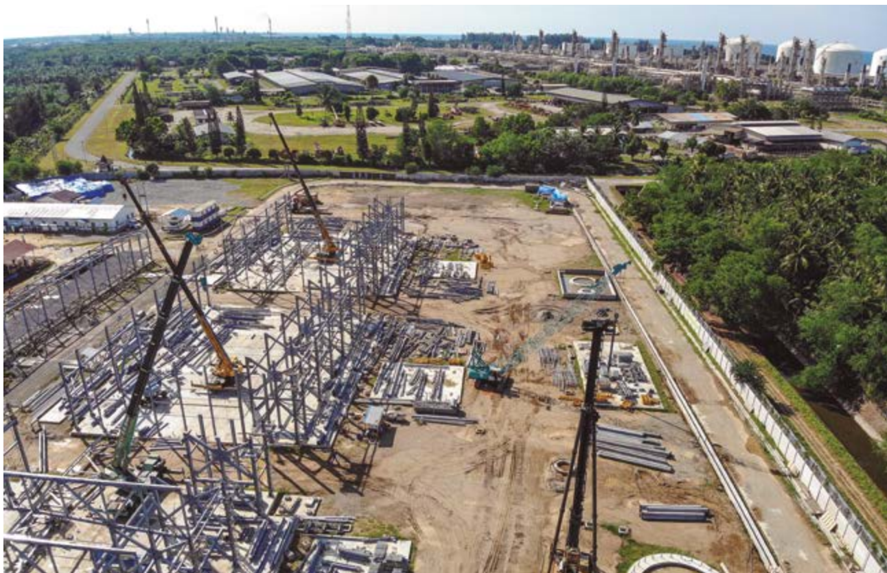
Sumbagut 2 Peaker. Central de motores de gas 250 MW. Lhokseumawe, Aceh (Indonesia)
