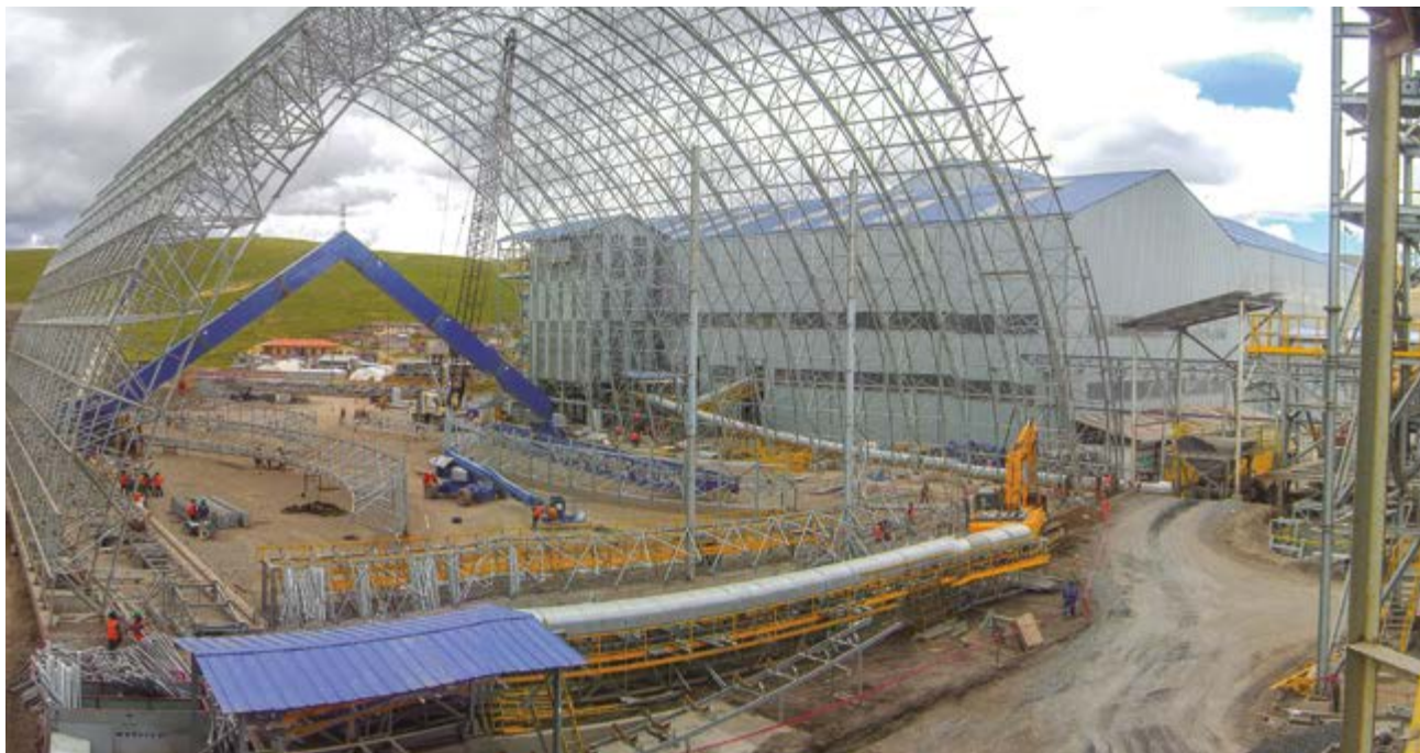
Mina EL BROCAL. Sistema de manejo y almacenamiento de concentrados polimetálicos. Colquijirca (Perú)
