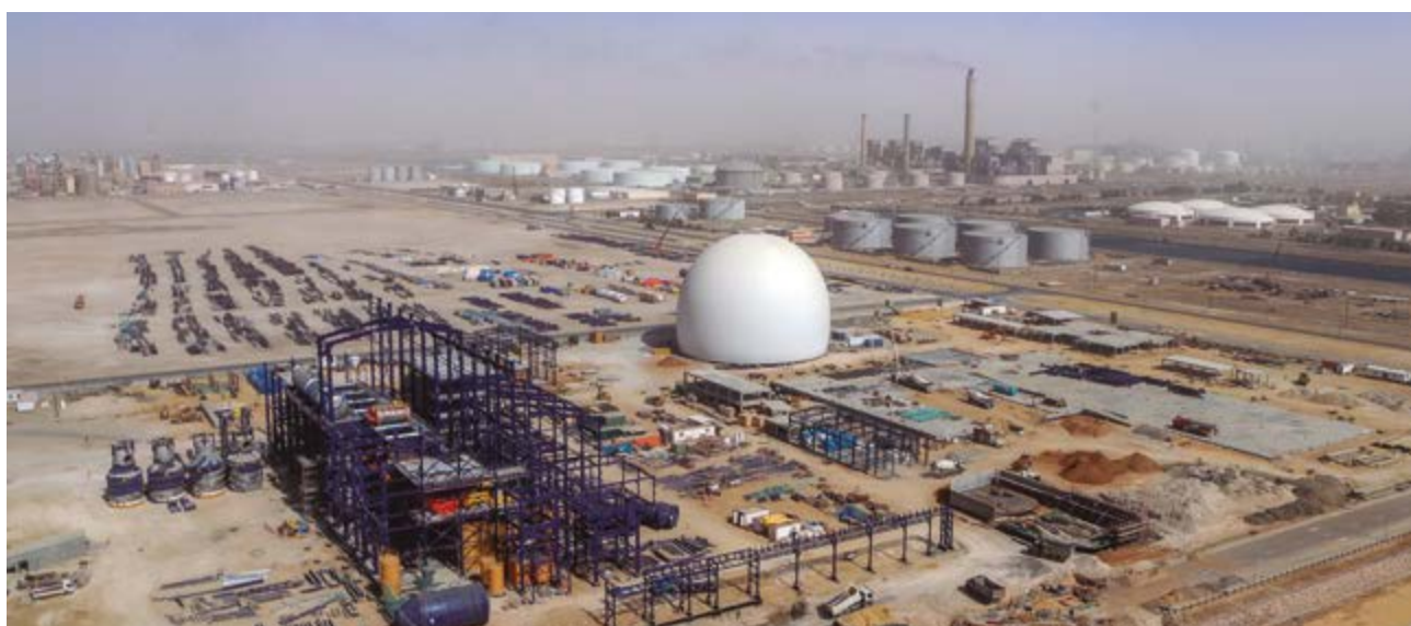
Refinería de Azúcar. Puerto Industrial King Fahad, Yanbú. (Arabia Saudita)
